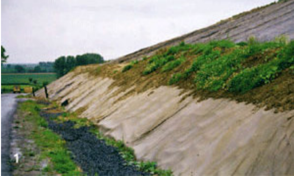
1 Terreno di copertura franato
